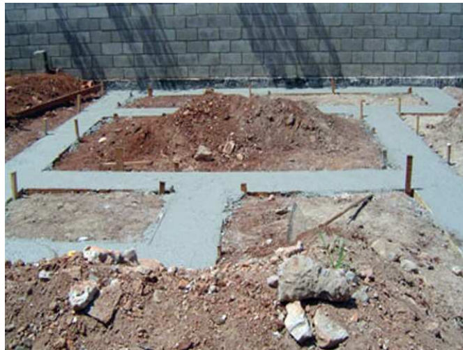
Depois de nivelada e curada passamos para a montagem dos tijolos sem adesivo.....
