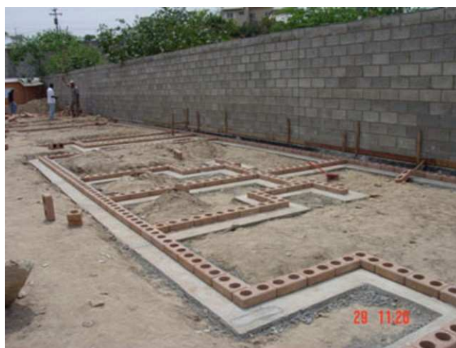
.....com a finalidade de modular as peças evitando assim, cortes e junções disformes.
